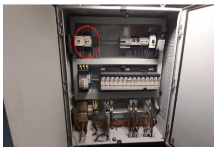
Fig. 1. Armario top abierto. Identificado el guardamotor Q102 / Top cabinet opened. Identify the Q102 circuit breaker
